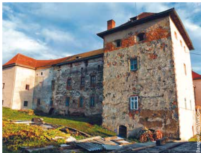
Najstarsza część Zamku Użgorod wymaga szybkich i poważnych prac konserwatorskich / Найстаріша частина замку ще чекає ремонтно-реставраційних робіт
